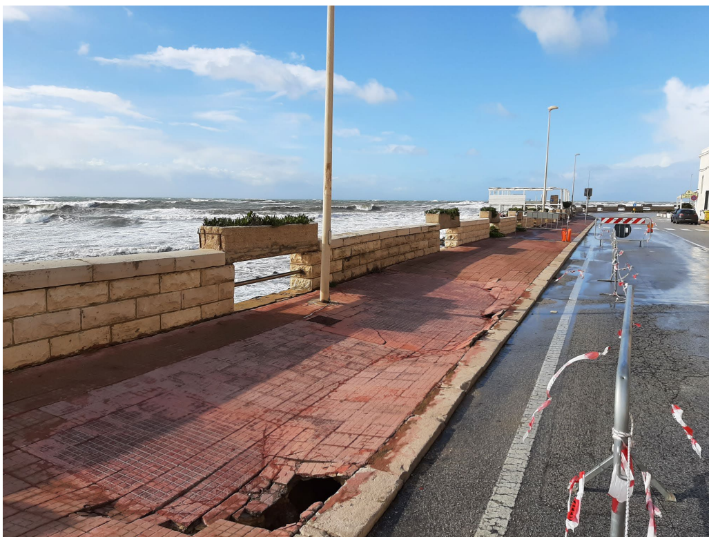
Marsala – fenomeni di erosione
